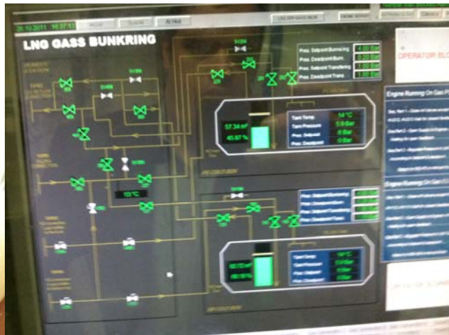
Measurement system for LNG – Fjord1
