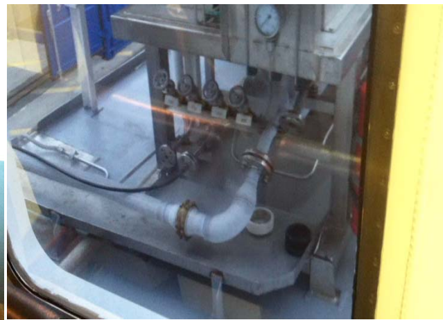
LNG bunkering station – Tide Sjo
